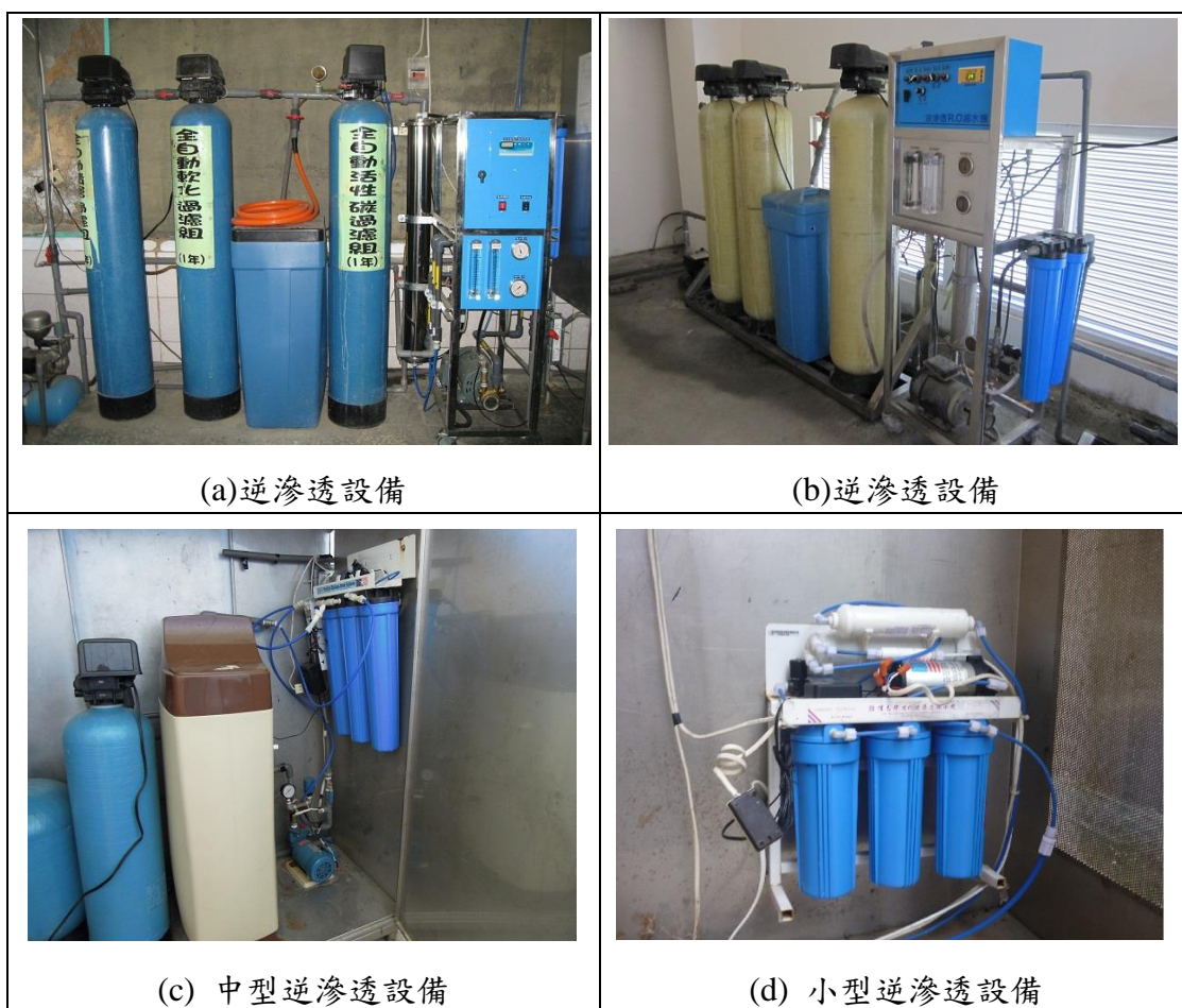
圖 4.17 中央處理系統及逆滲透裝置
