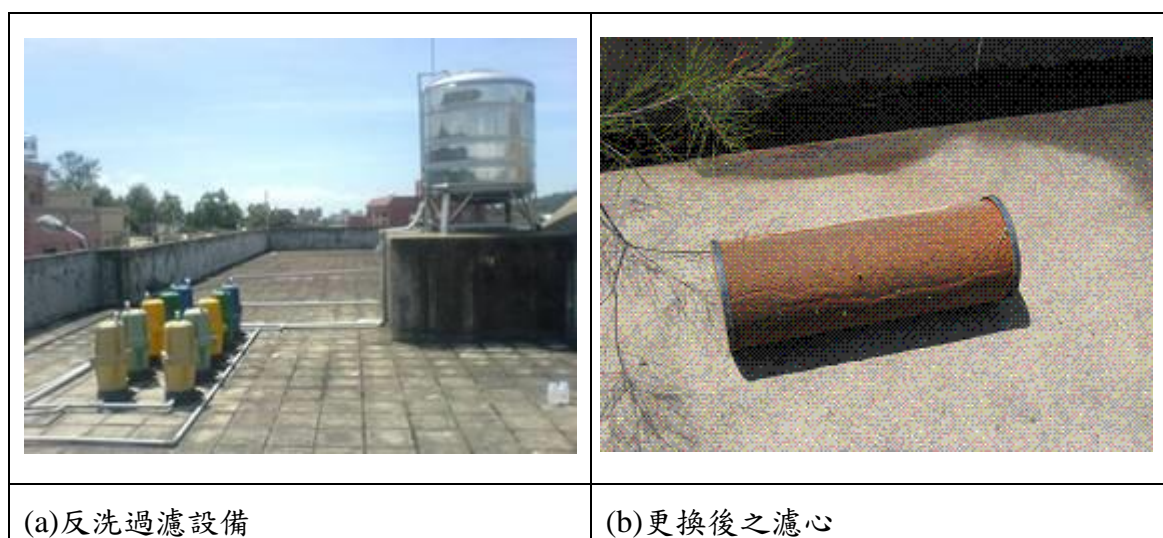
圖 4.14 反洗過濾設備
