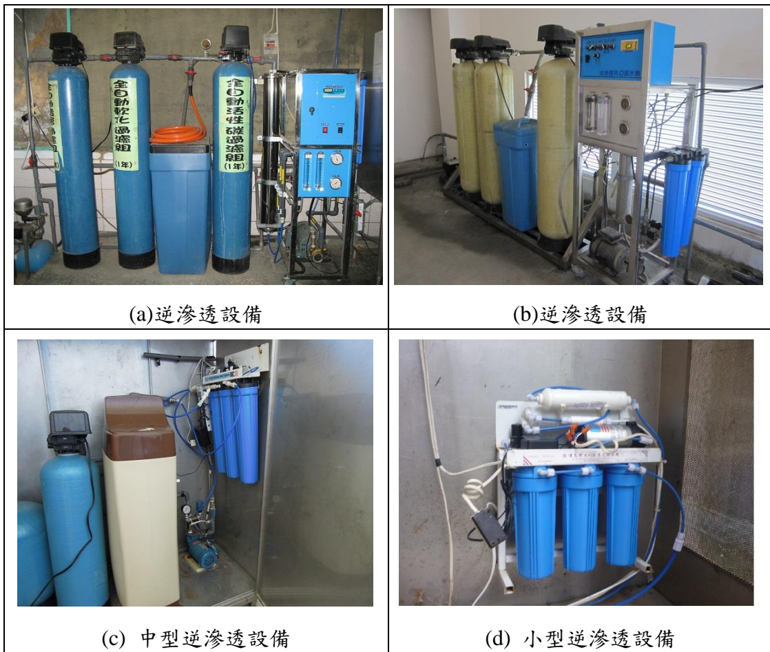
圖 4.17 中央處理系統及逆滲透裝置
