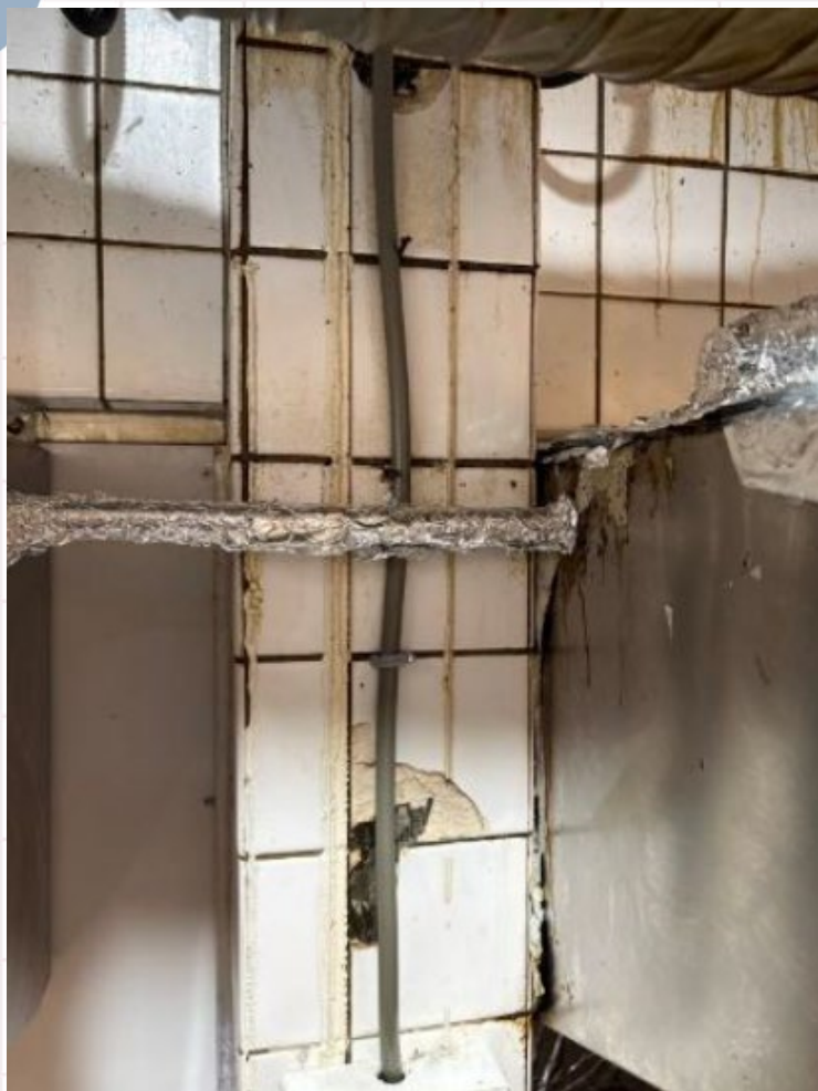
牆壁髒污及破損
