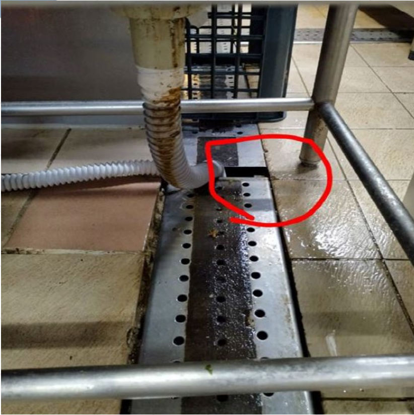
水溝蓋孔洞過大
